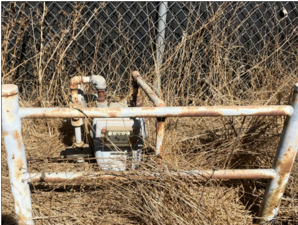
12. Natural Gas Meter
